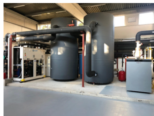
Slika: Prenovljena kotlovnica Šolski center Zlato polje
